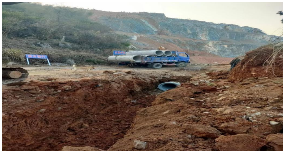
图 2-1 排水系统现场照片
