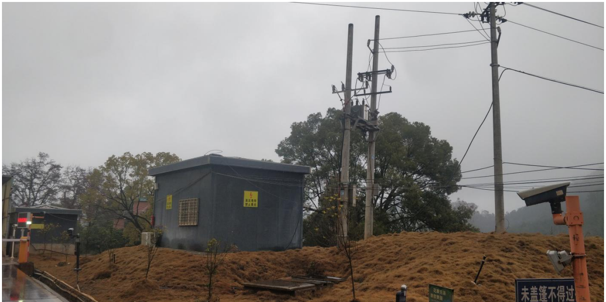
图 2.6-9 变压器及配电室
