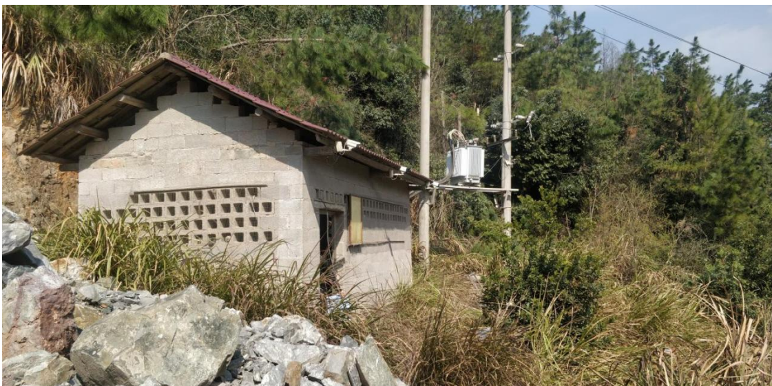
图 2.4-2 配电室及变压器
